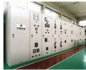
受配電盤・制御盤
