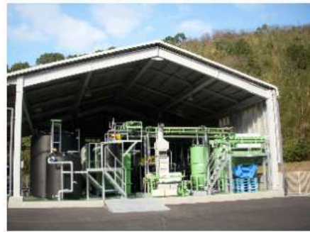
▲ 排水処理設備
