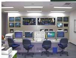
中央監視制御システム
