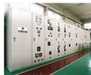
受配電盤・制御盤
