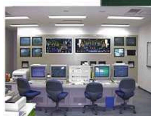
中央監視制御システム
